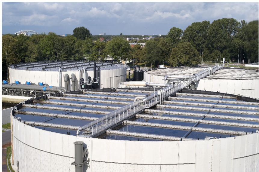
Foto: Nereda installatie RWZI Utrecht
