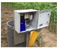
Figuur 4 Installatie voor Klimaat Adaptieve Drainage (KAD). (Bron: STOWA 2012-33).
