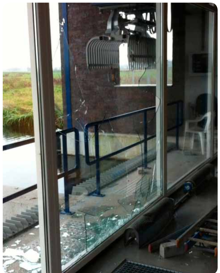
Ruitschade in het gemaal Oud-Kamerik
