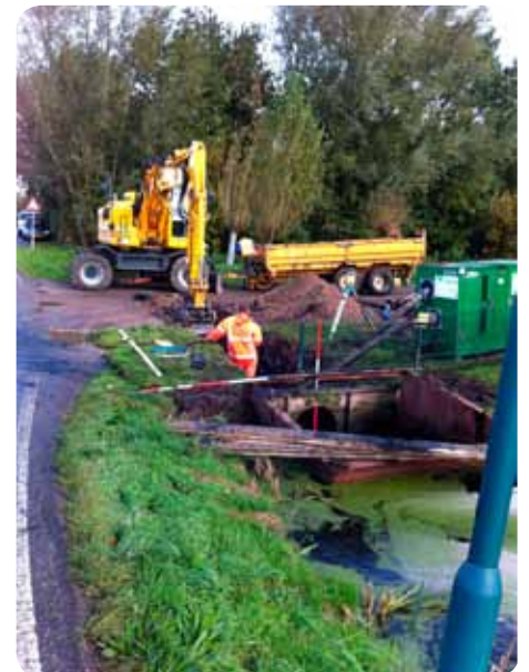
De aanleg van een duiker onder de openbare weg door valt niet altijd mee
