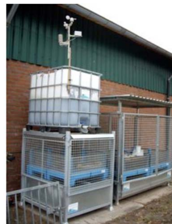
Figuur 3.4 Als het osmose-systeem beschut staat, treedt er minder verdamping op.
