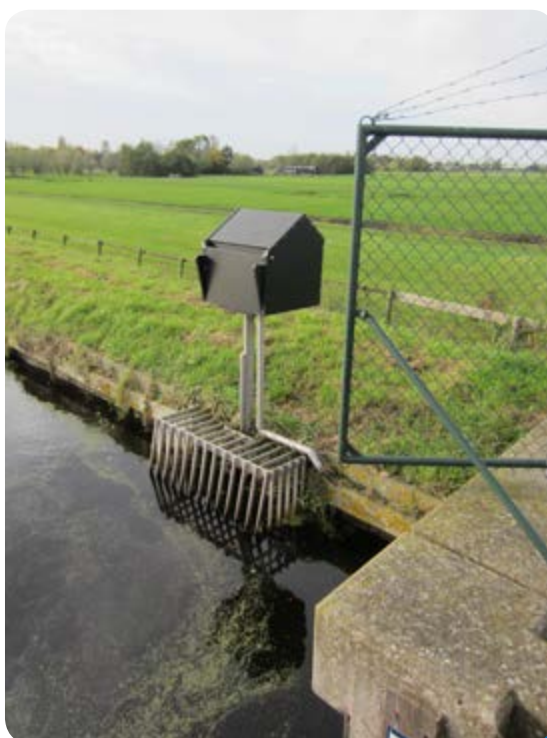
Gemaal langs de Meijevliet
