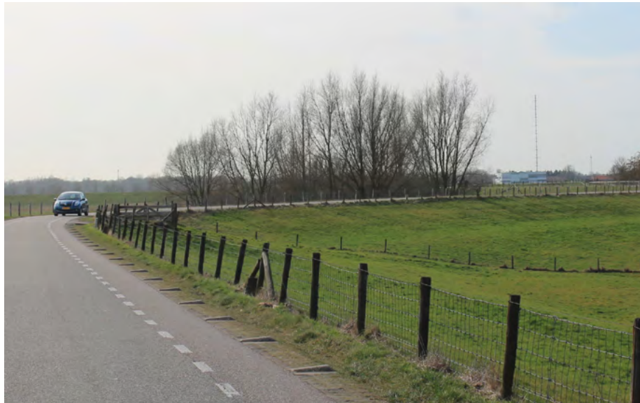
Geknikt talud in de dijk
