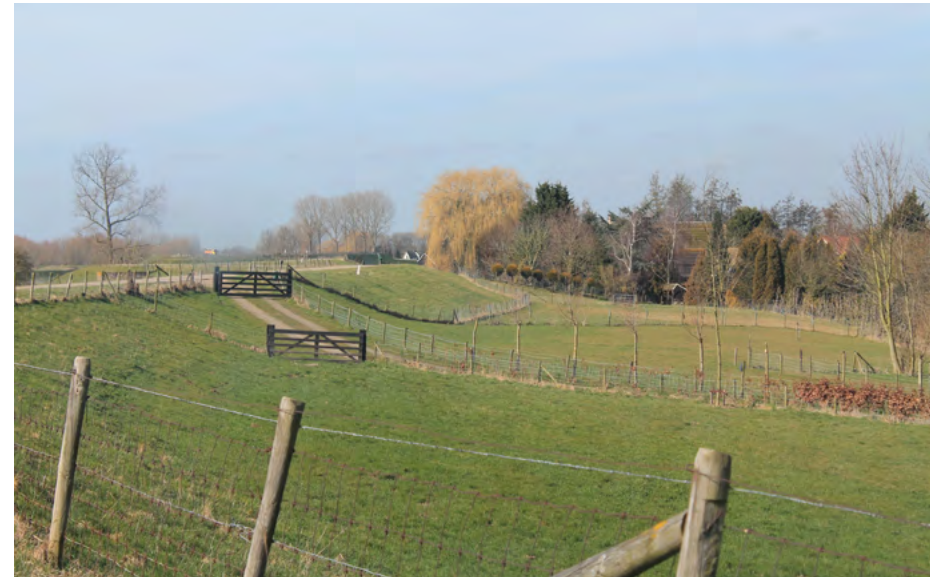
Glooiende dijk en brede steunberm
