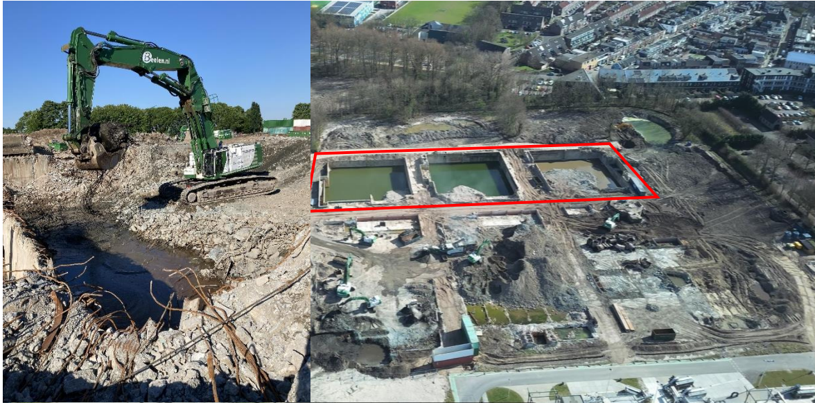
Een luchtfoto van de situatie in maart. Rood omkaderd de beluchtingstanks die momenteel worden gesloopt.
